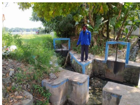
Jalur Pintu air irigasi yang menuju ke saluran masuk embung dan ke saluran irigasi yang menuju ke lahan pesawahan.
